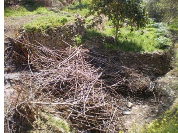
Obstrucciones en el cauce
